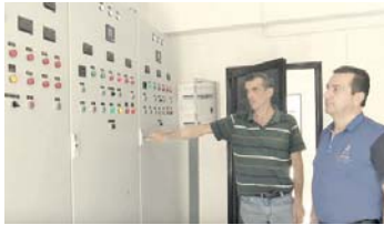
На новой водонапорной станции в провинции Латакия.
